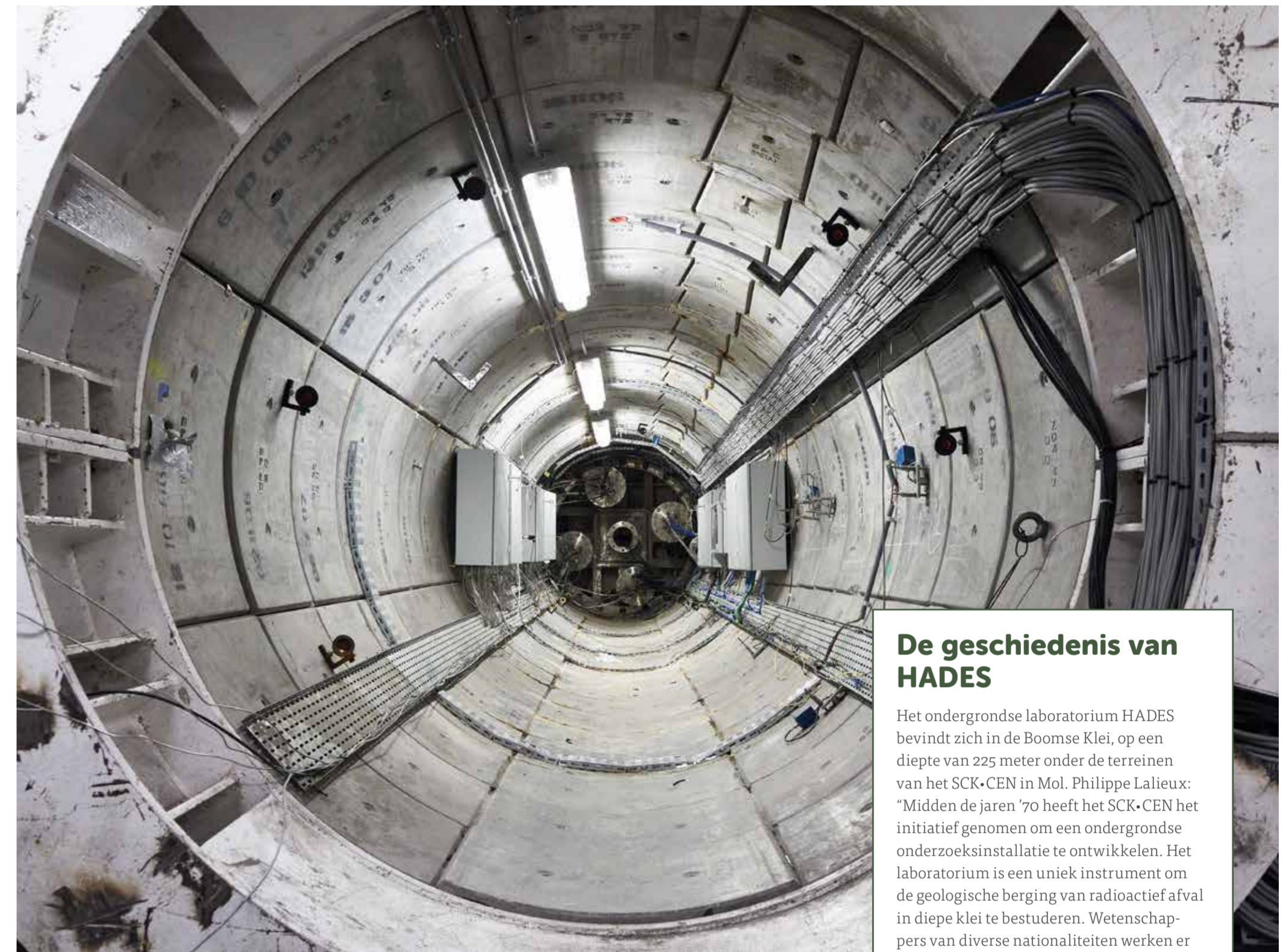
In de PRACLAY-galerij in HADES wordt momenteel een grootschalig experiment uitgevoerd.
