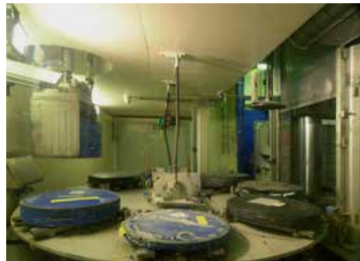
De pers van de CILVA-installatie perst het vat met afval samen.
