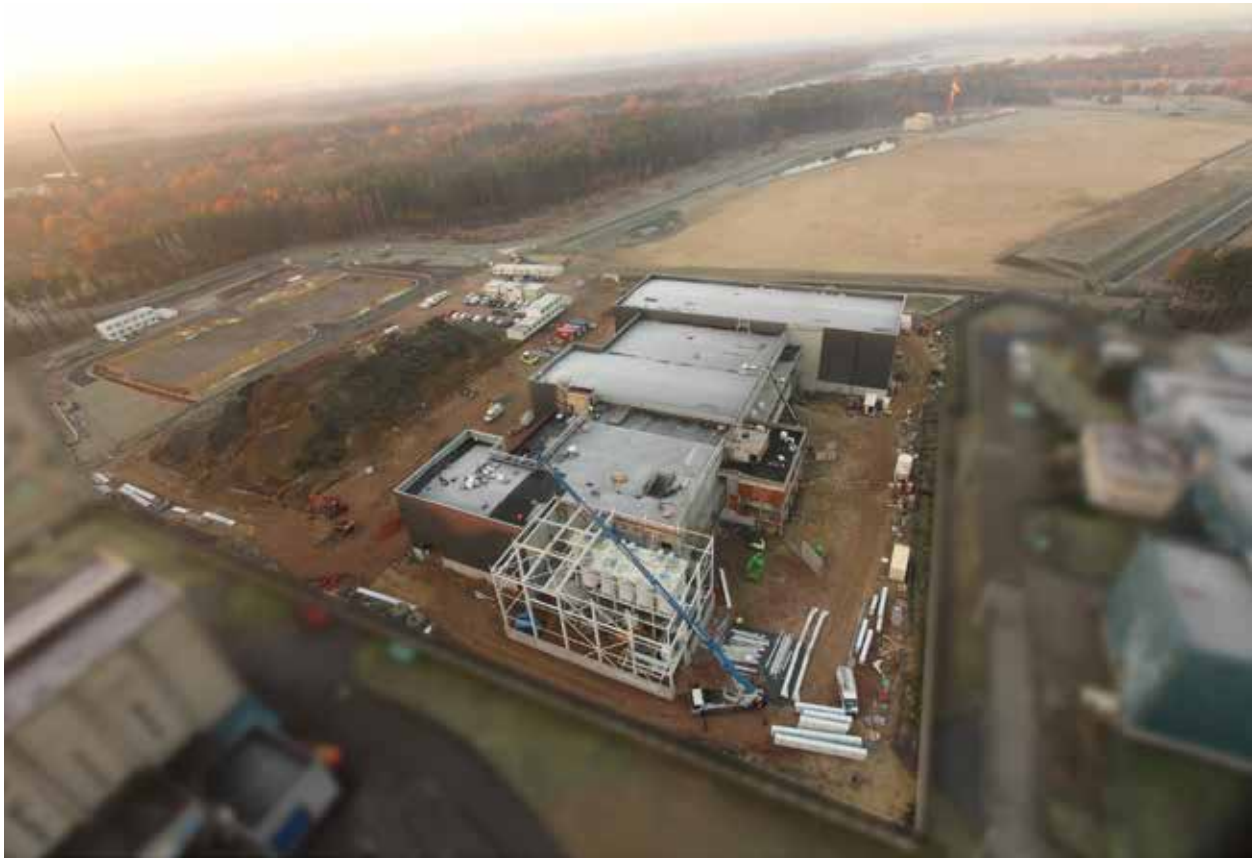
De silo's van de doseer- en menginstallatie in de IPM werden onlangs opgebouwd en gemonteerd.
