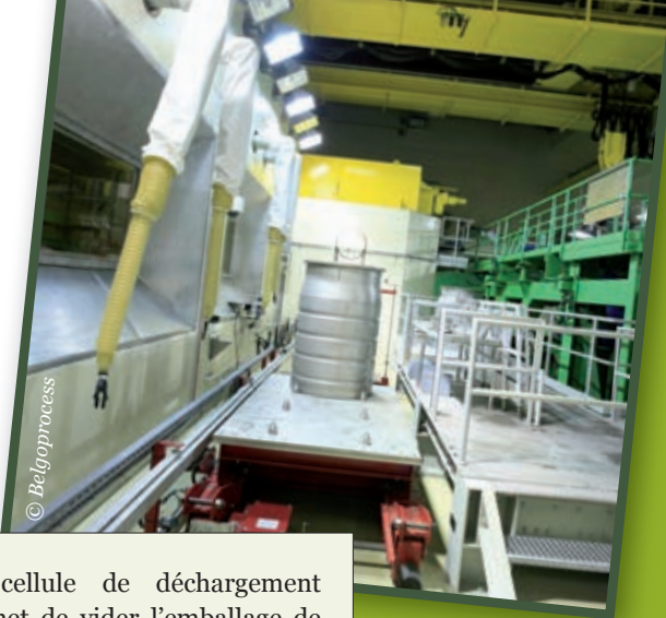
Cellule de déchargement
